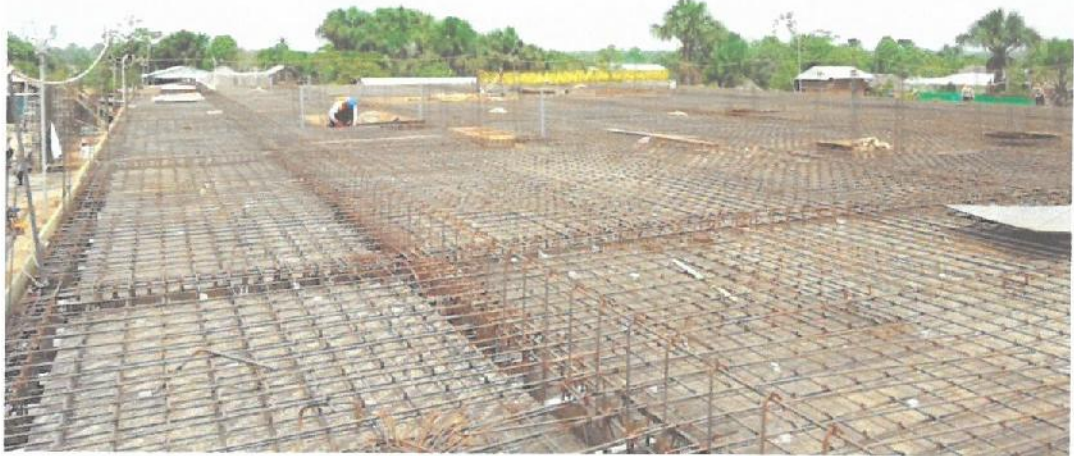
Fotografía N° 03: Colocación de acero en vigas peraltadas y losa maciza en el Módulo D.
