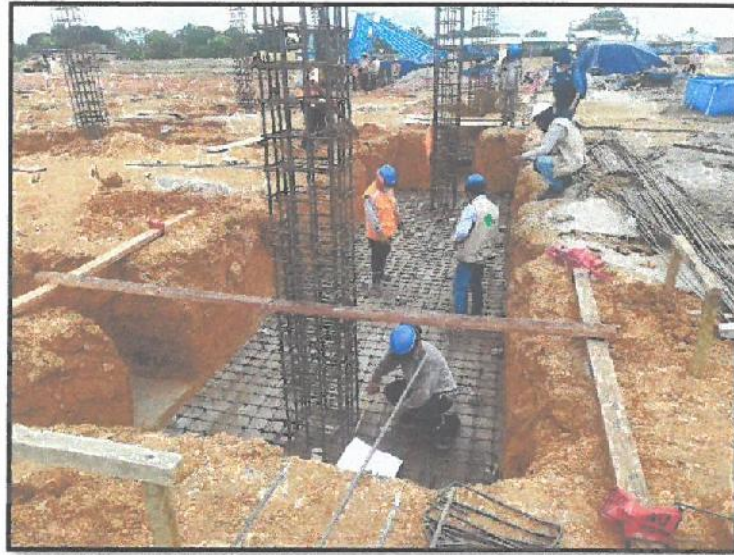
En la vista se aprecia, la habilitación de acero para el armado de las vigas de cimentación y sobrecimientos en Sector D bloque 1
