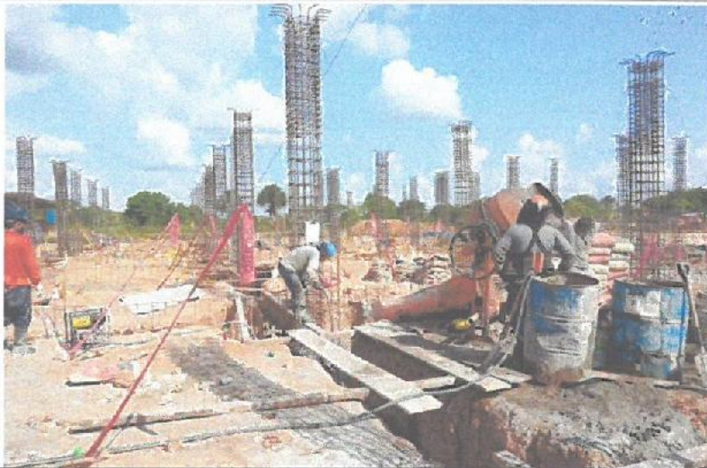
Vaciado de concreto f_c = 210 \text{ Kg/cm}^2 para Zapatas (Bloque D), con trompito y vibrador de concreto.
