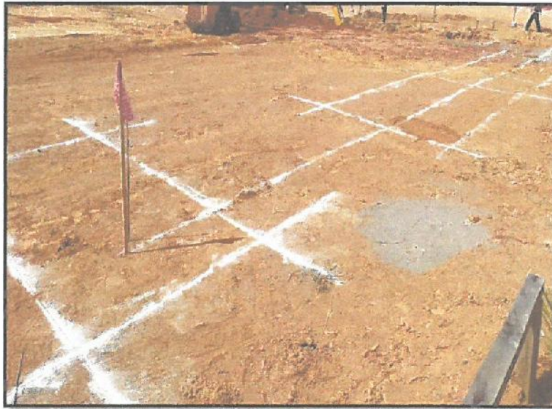
En la vista se aprecia, la realización de Nivelación y trazos en Sector D bloque 1
