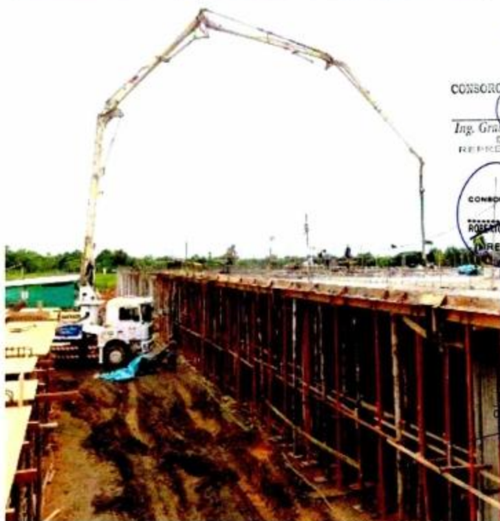
Vaciado de concreto F_c = 210 \text{ Kg/cm}^2 de losa maciza en Módulo D.
