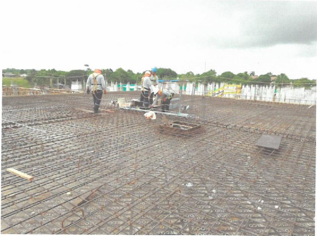
Fotografía N° 09: Instalación de accesorios sanitarios y eléctricos en losa maciza del Módulo B-1.
