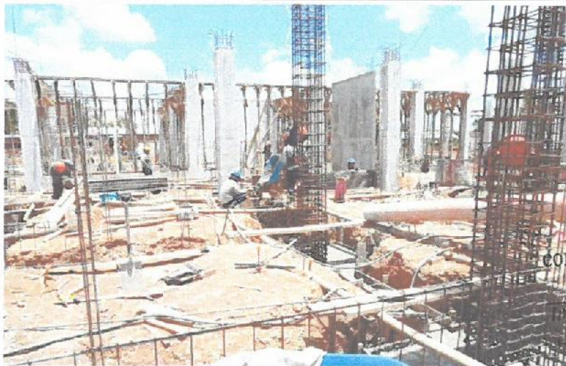
Vaciado de concreto en zapatas y vigas de cimentación en el Bloque B-1.
