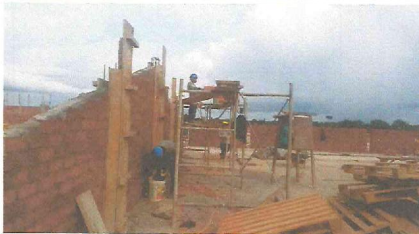
Colocación de Acero y Encofrado de columnetas en los Timpanos del Sector A1, Bloque A1.
