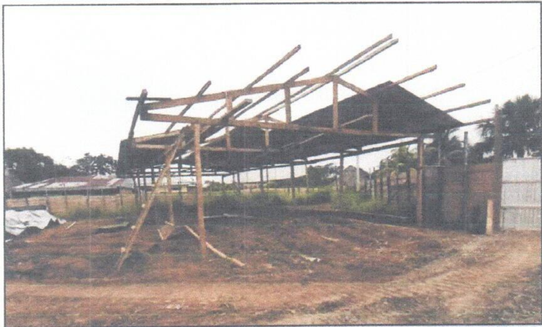
En la vista se aprecia, la colocación de techo(calamina) en el almacén.
