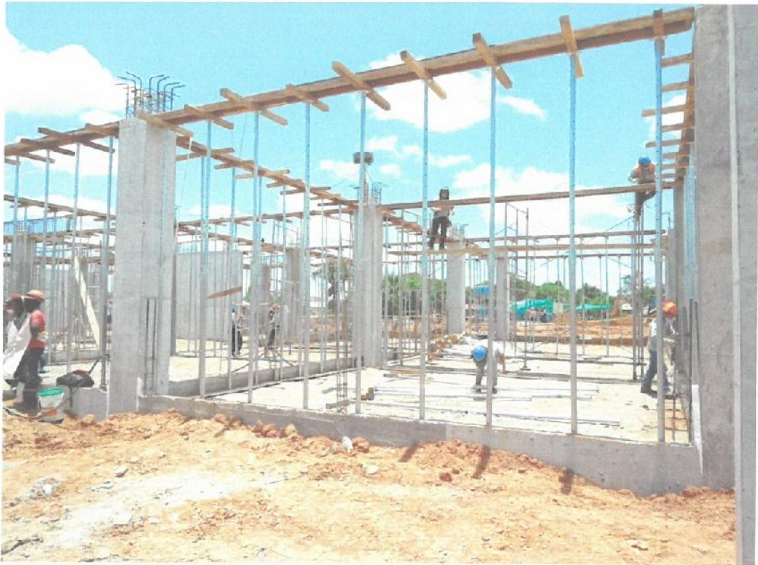
Fotografía N° 05: Encofrado de fondo de vigas peraltadas para losa aligerada en Módulo A-1.
