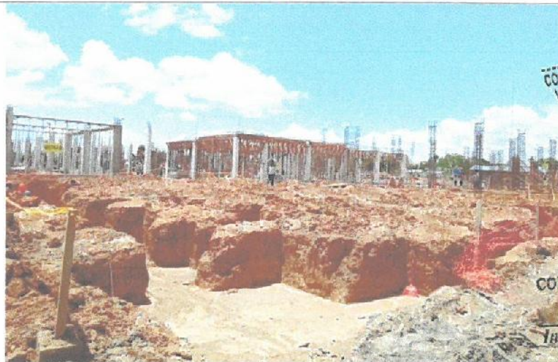
Control de niveles para trabajos de excavación de zanjas para zapatas y vigas de cimentación en el Bloque A-1.
