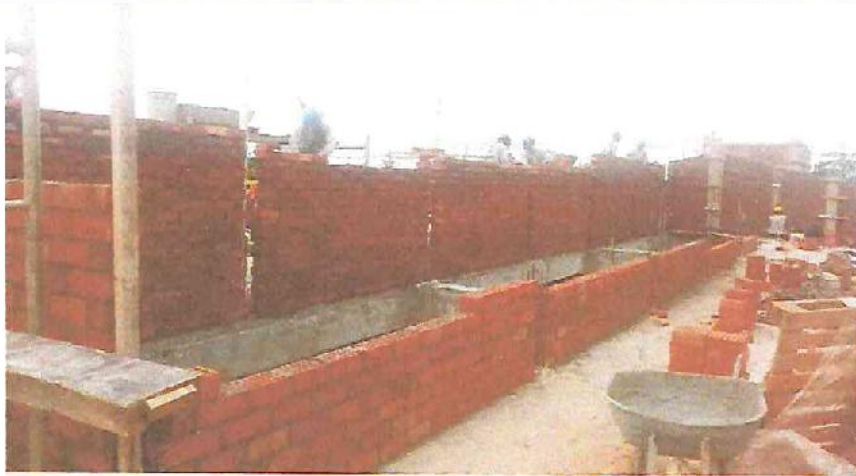
Asentado de ladrillo King Kong en ductos del sector A1, Bloque A2
