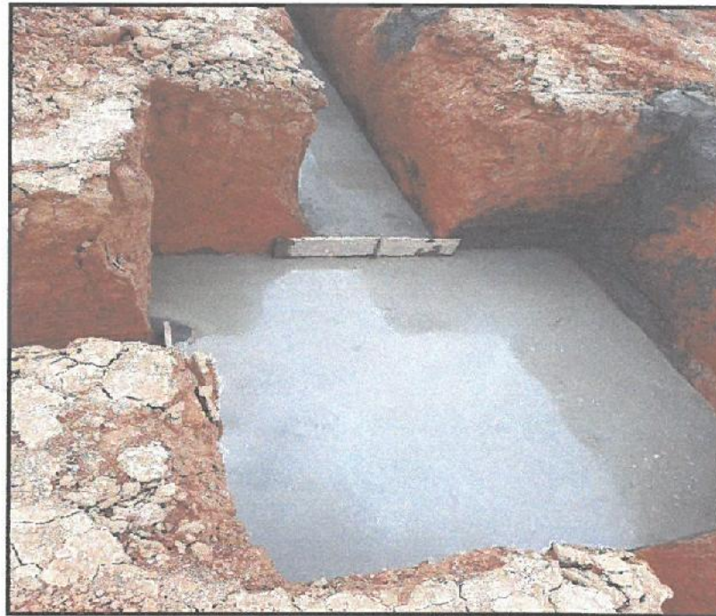
En la vista se aprecia, el vaciado de concreto para Solado en el Sector D bloque 1
