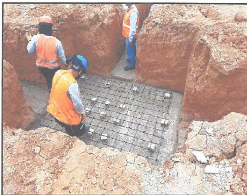
En la vista se aprecia, la colocación de los dados de concreto en Sector D bloque 1
