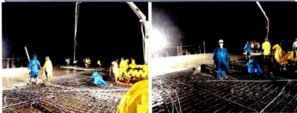
Vaciado de concreto f_c = 210 \text{ Kg/cm}^2 de losa maciza en Módulo D.
