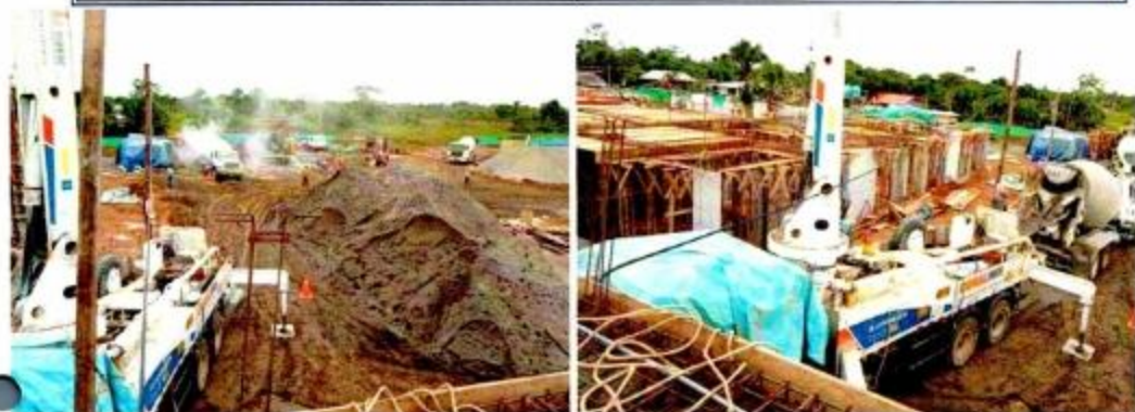
Planta dosificadora de concreto para producción de concreto F_c = 210 \text{ Kg/cm}^2 para losa maciza.
